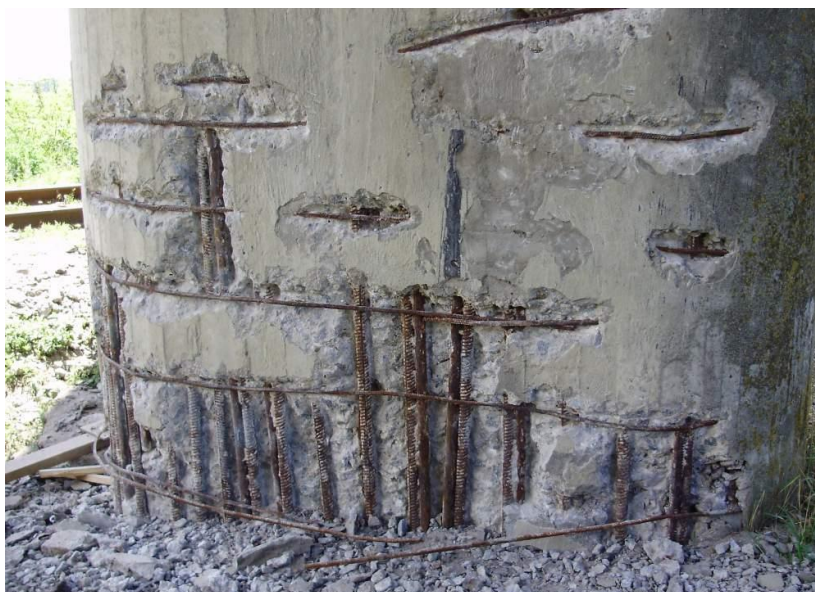
Рис. 2. Признаки коррозии арматуры в бетоне
