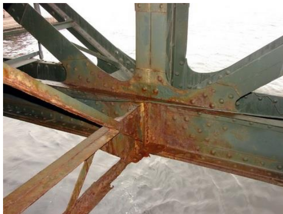
Рис. 2. Коррозия в узле фермы железнодорожного моста
